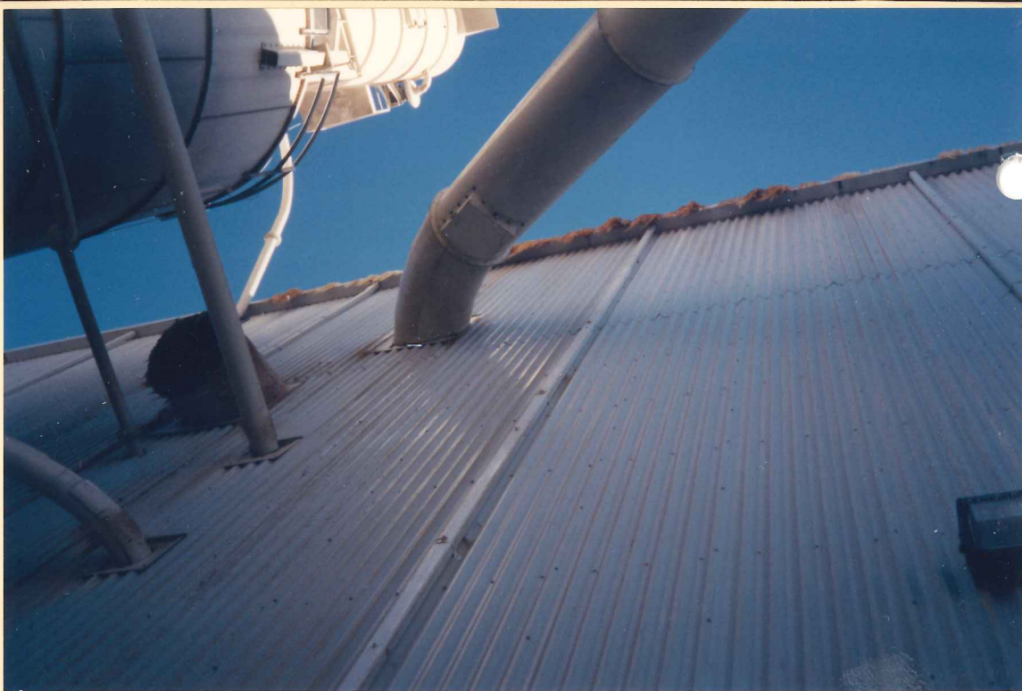
① Contaminant venant du toit
