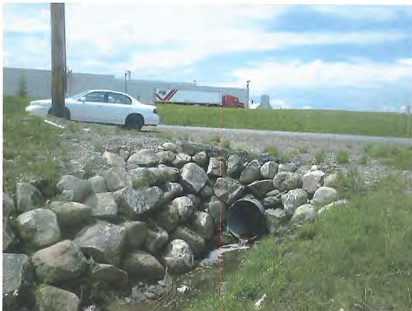
1. Fossé à proximité du poste de garde où le premier échantillon a été prélevé.
