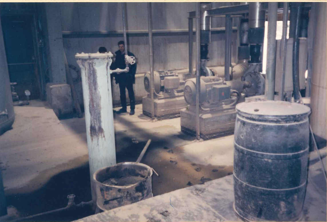
③ Bassin de rétention d'huile usée et eau contaminée
