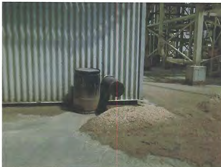
3. Trop plein de la recirculation du WESP
